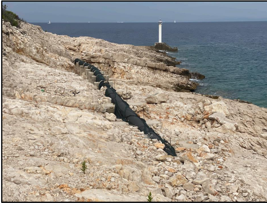
Slika 2.2-4. Širi prikaz oštećene dionice kopnenog dijela podmorskog ispusta ( preuzeto iz: AEQUUM d.o.o., 2022. )
