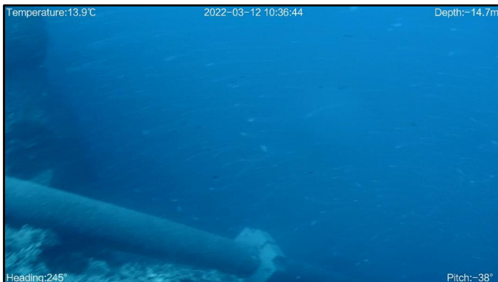
Slika 2.2-5. Dio cijevi podmorskog dijela ispusta koji je samo djelomično oslonjen ( preuzeto iz: AEQUUM d.o.o., 2022. )
