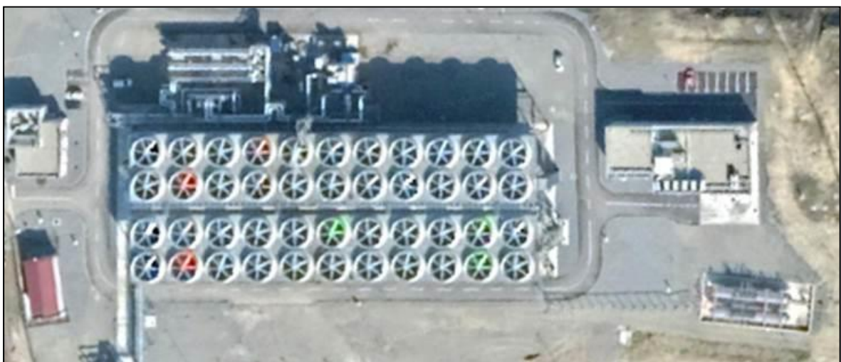
Sl. 1-1: Modularne jedinice zračnog kondenzatora za radni medij (Geotermalna elektrana Velika Ciglena)
